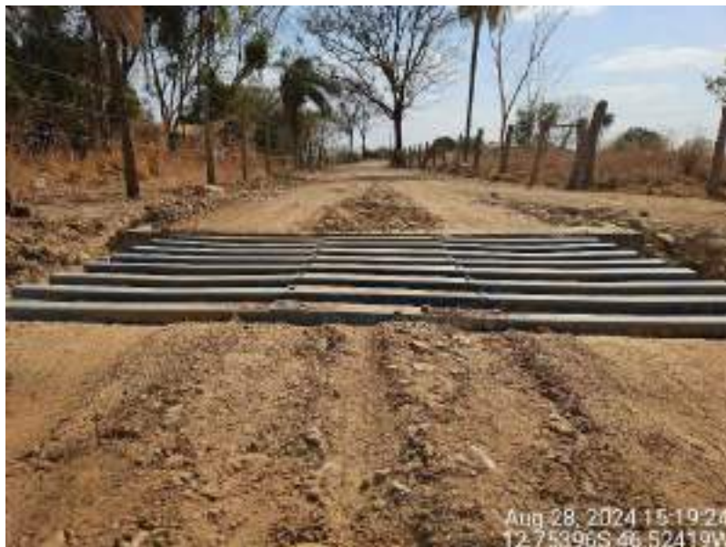
Figura 84: Registro fotográfico de mata-burro com pequeno deslocamento vertical nas trilhas por onde os veículos trafegam.
