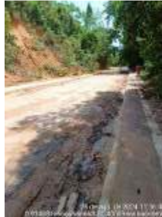
Detalhe da execução da calçada e da base revestida com lama asfáltica – Trecho 2
