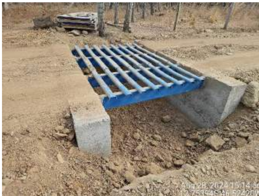
Figura 86: Registro fotográfico de mata-burro executado.
