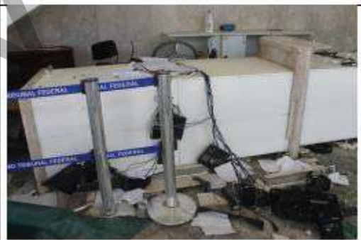
Bancadas em mármore quebradas
