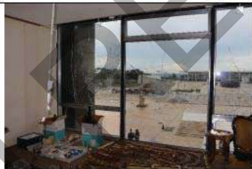
Salão Nobre com painéis de vidro da fachada vandalizados
