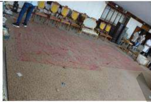
Salão Nobre com carpete manchado e encharcado
