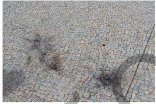
Manchas de fogo no piso de pedra portuguesa
